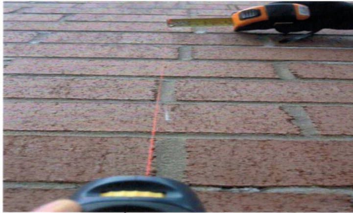
photo 21 - Désalignement de 30mm
